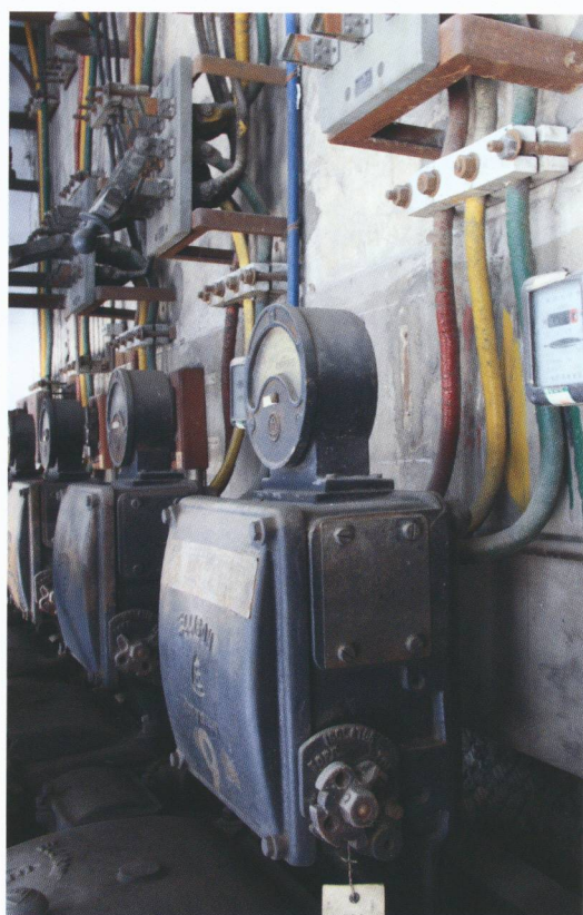
5号楼内20世纪30年代的德国西门子配电设备
